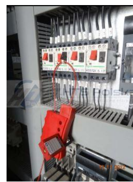
Blokowanie wyłączników linką nylonową.
