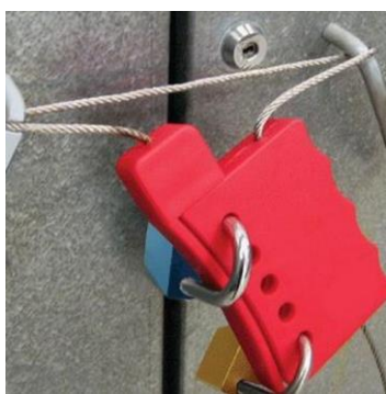
Zabezpieczenie uchwytów szafy; widoczna linka stalowa.
